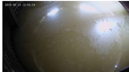
圖 26 2019 年 05 月 15 日集水井攝影機影像 Figure 26 Vedio image of drainage well on 15/05/2019
