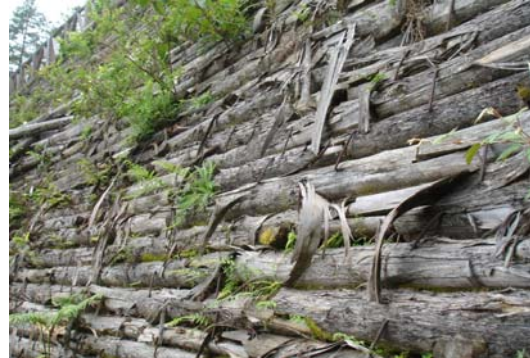
(b)牆身劣化現況
