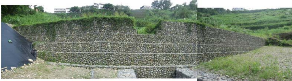
圖 10 林北坑源頭邊坡下方之箱籠防砂壩 (來源：現地勘查，時間：2007)
