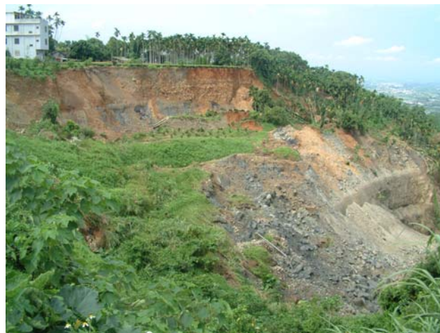
圖 3(b) 加勁擋土牆破壞照片(來源：鋒環公司，拍攝時間：2004)
