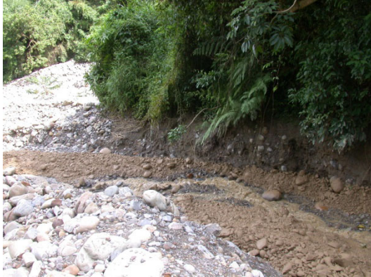
圖16. 溪流侵蝕坡腳
