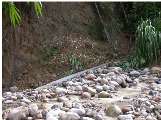
圖15. 逆向坡節理切割
