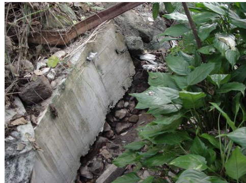
圖 10. 排水溝破損 Figure 10. broken drainage.
