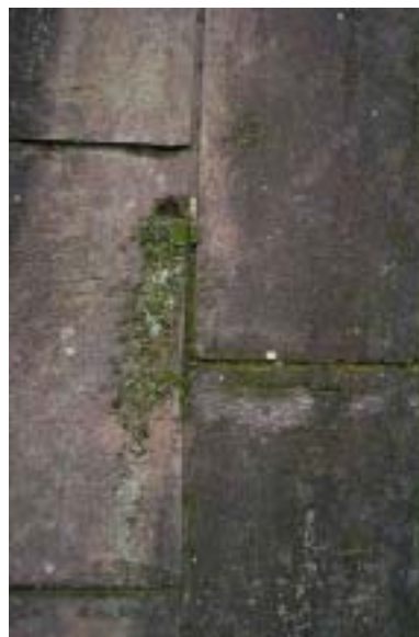
圖 9 擋土牆排水孔堵塞後形成潮溼表面長滿青苔。
