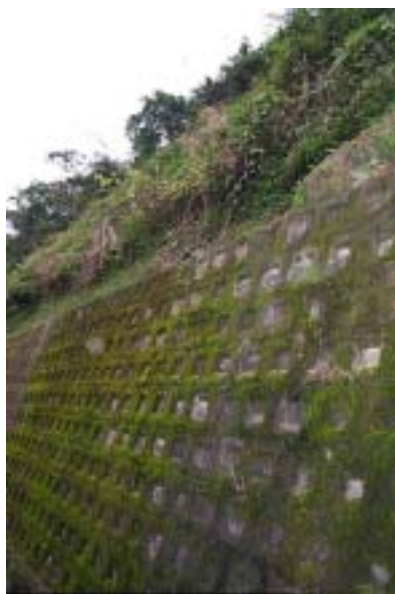
圖 7. 背陽之擋土牆因溢流水而使潮溼牆面處長滿青苔
