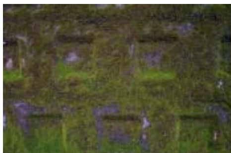
圖 8. 擋土牆潮溼牆面處長滿青苔而可能成為小黑蚊下卵及幼蟲棲地
