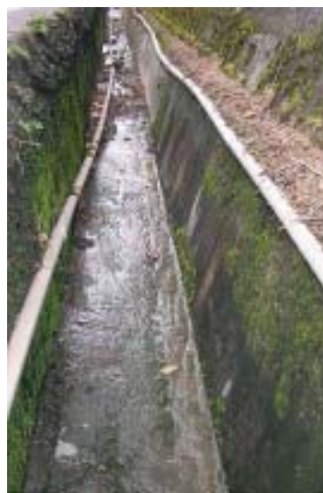
圖 10. 排水溝側牆因潮溼表面長滿青苔
